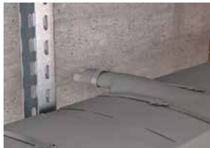
Кабельный вывод с бандажированием.
