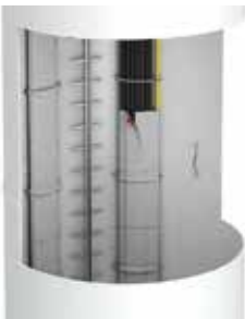
Бандажированная вертикальная трасса в башне ветросиловой установки.
