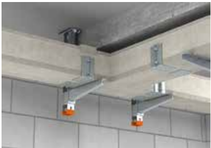
Предварительно смонтированные стандартные фасонные детали в трассах.
