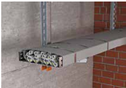
Полное бандажирование подвесной кабельной трассы.
