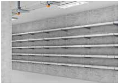
Кабельный туннель с бандажими в силовых установках.
